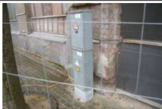
Dzīvojamā ēka ar kadastra apzīmējumu 6405 007 0006 001, elektropievads/sadales skapis
